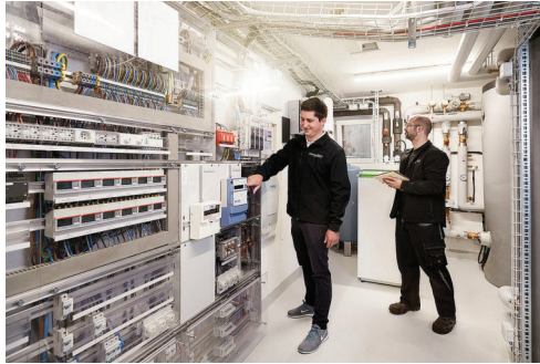
Die zentrale Steuerung.
